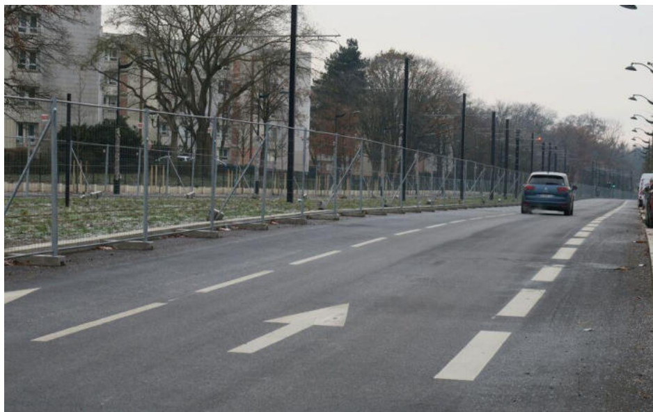
Le Plessis-Robinson (Hauts-de-Seine), le 18 décembre 2022. Le Collectif Vélo VSGP dénonce la non-conformité des bandes cyclables en train d'être aménagées. Leur largeur ne respecte pas, selon eux, la taille préconisée par les experts. LP/H.D.
